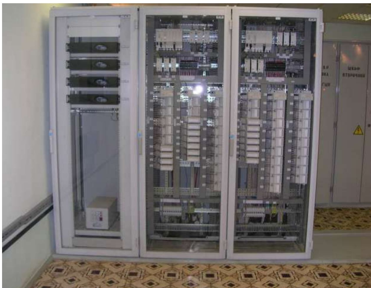
Рис. 1.3. Панели с контроллерами и модулями УСО
