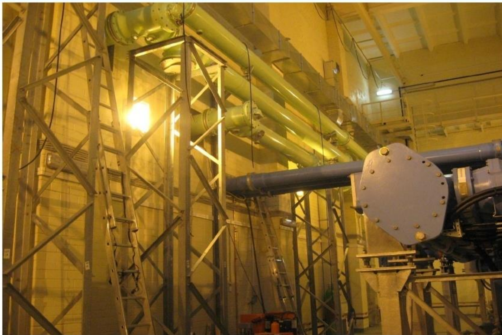
Элегазовые токопроводы 330 кВ и 220 кВ в КРУЭ 220 кВ ПС 330 кВ Завод Ильич СПб.
