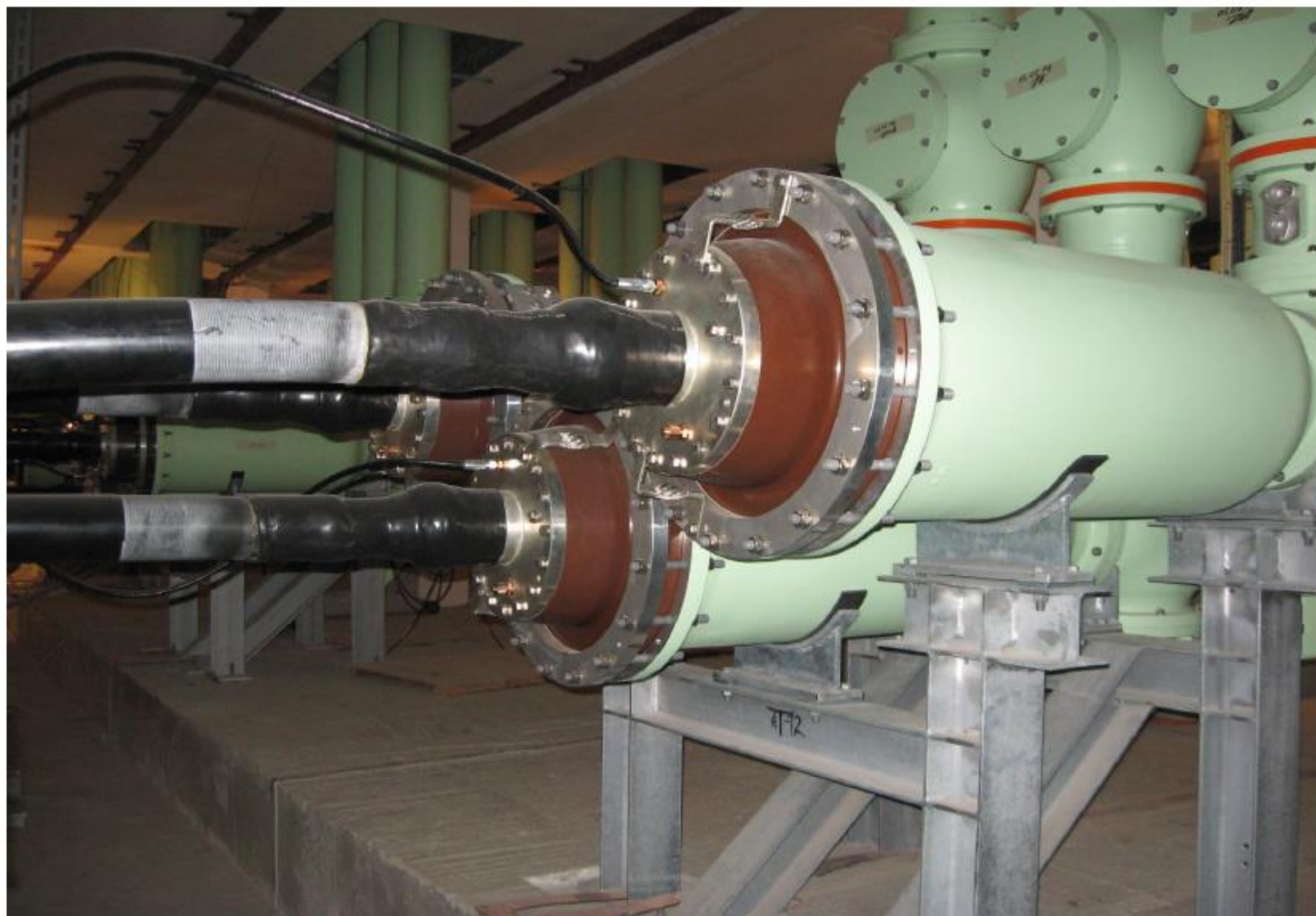
Кабельный заход в КРУЭ 220 кВ ПС 500 кВ Очаково в кабельном подвале.
