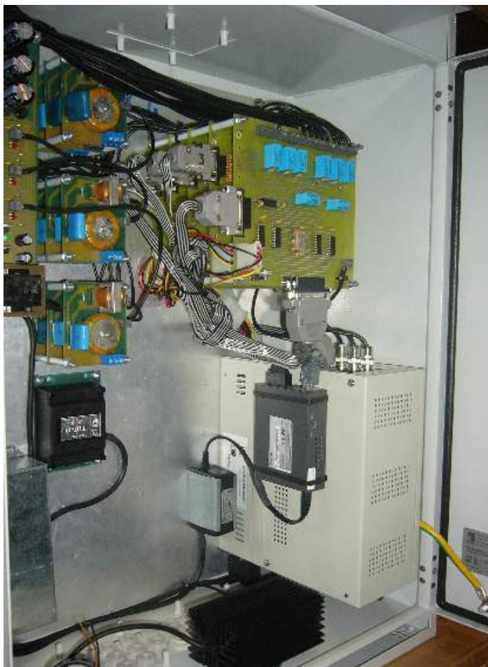
Рис.4. Внешний вид трансформаторного модуля.
