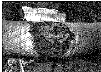
Рис. 7. Место повреждения ТТ типа ИМВ- 550 из [1]
