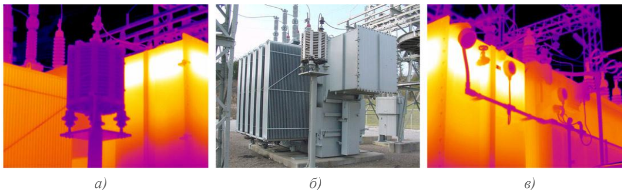
Рис. 8. Контроль степени нагрева в блоке переключателя обмоток масляного трансформатора 25МВА.
