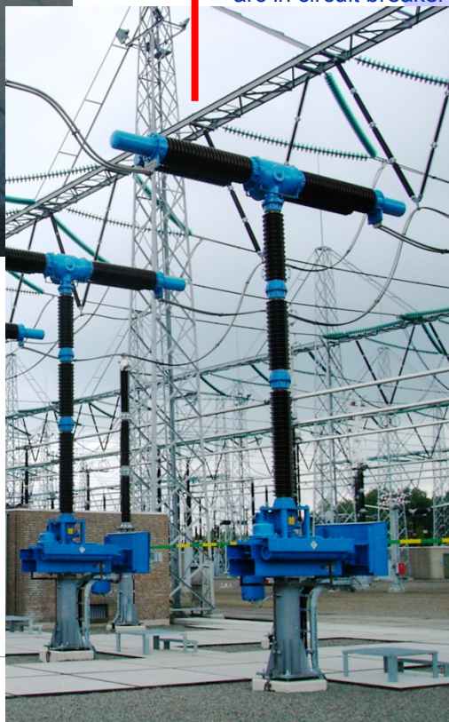
ВВ выключатель на подстанции HV circuit breaker in an electrical substation
