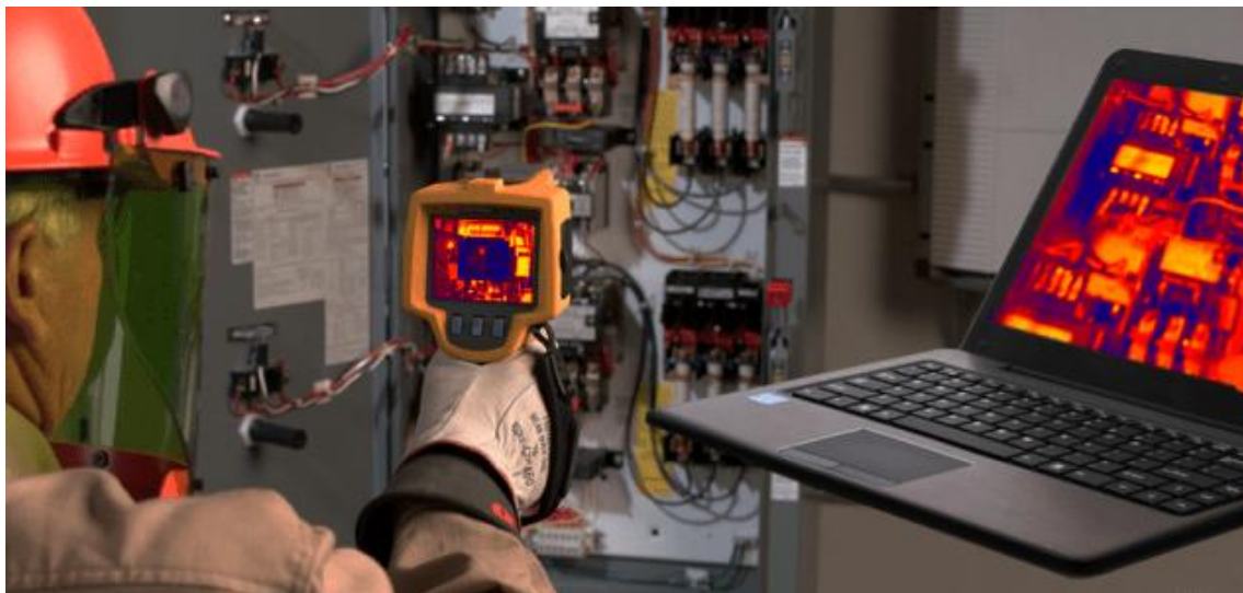
Рисунок 20. Пример проведения тепловизионного контроля электрошкафа
