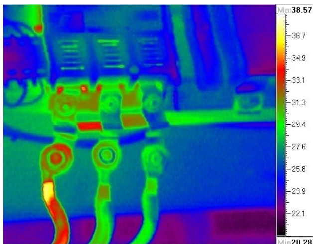
Рисунок 21. Пример термограммы контактных соединений с температурной шкалой
