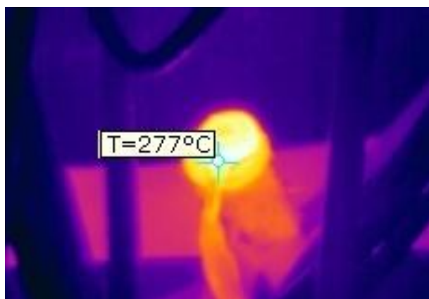
Рисунок 22. Пример обнаружения пожароопасного разогрева болтового контактного соединения
