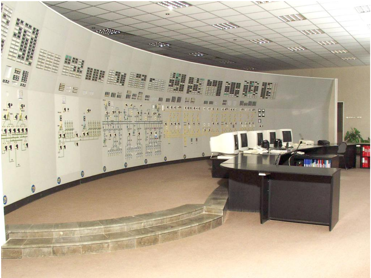
Рис. 57. Главный щит управления Московской ТЭЦ 27
